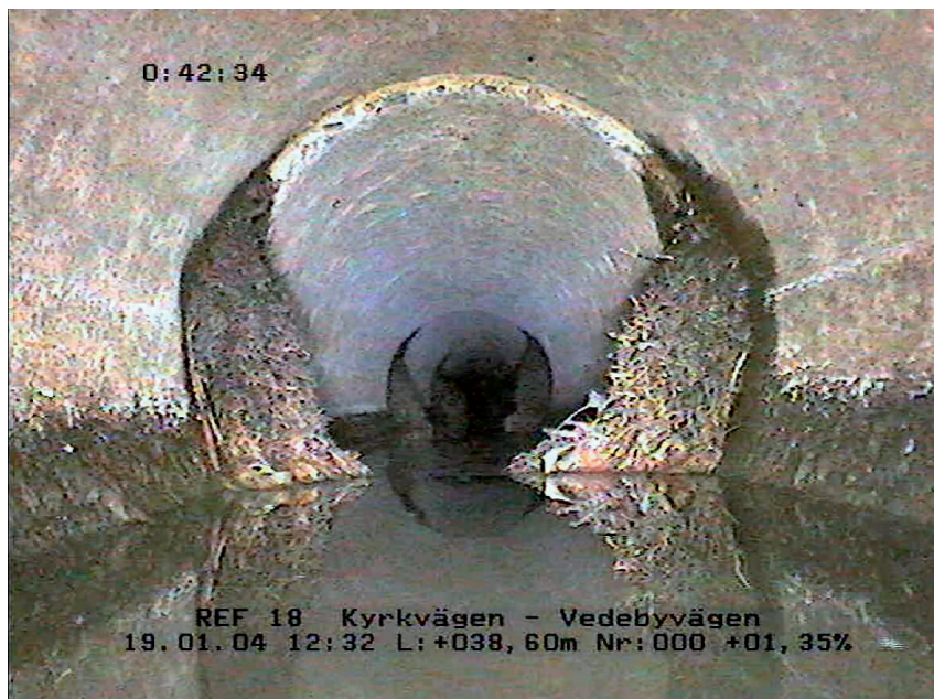
Rotinträngning i avloppsledning i Katrineholm.
